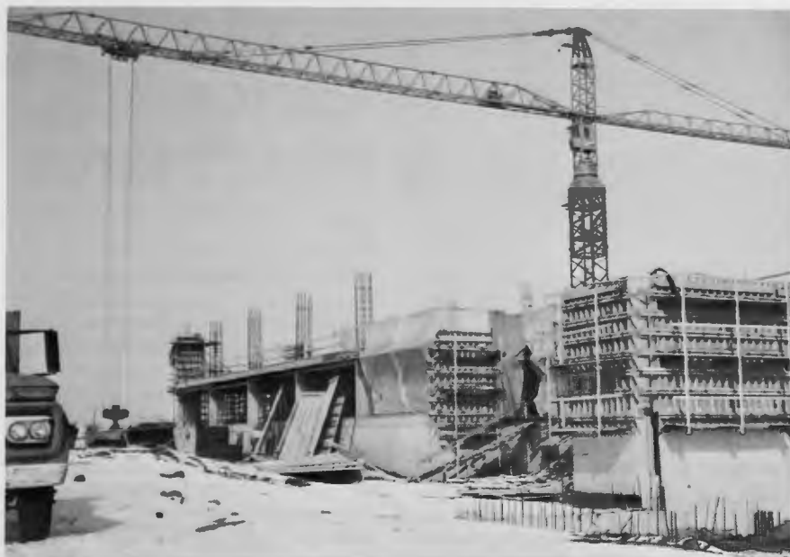
Le bâtiment du SEA était en pleine construction lors de la prise de cette photo en février 1970.
